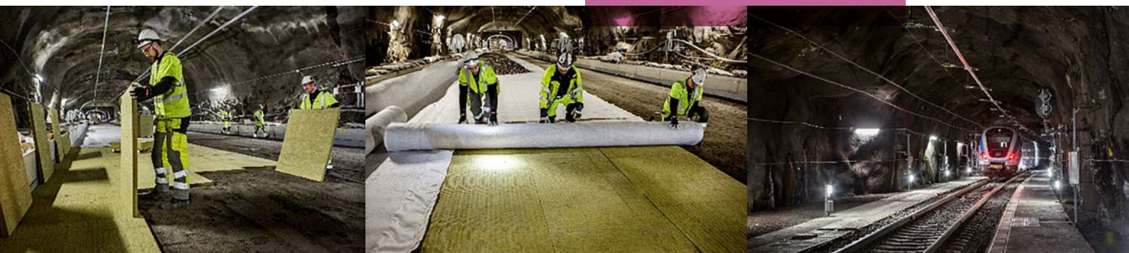
Steenwol gebruikt onder een trambaan.
